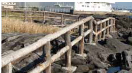
台風によって砂が流され、保護柵の土台がむき出しになった。
